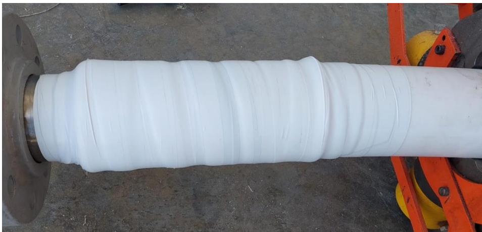
Fig. 30 – cinta de PVC sobre protección mecánica.
